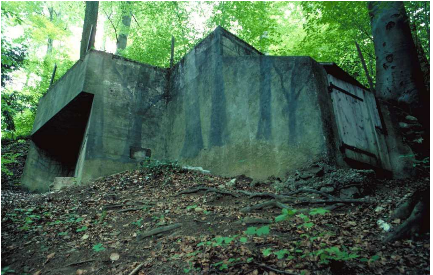
Ansicht aus dem Steilhang vom unteren Stand her kommend. Linkerhand der Schartenbereich und rechts der Zugangsbau mit hier noch vorhandener Holztüre. Bild: Denkmalpflege Kanton Zürich
